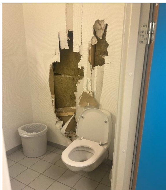
Hærverk på Gjøklep ungdomsskole i september 2025. Foto: Frode Røstvang.
