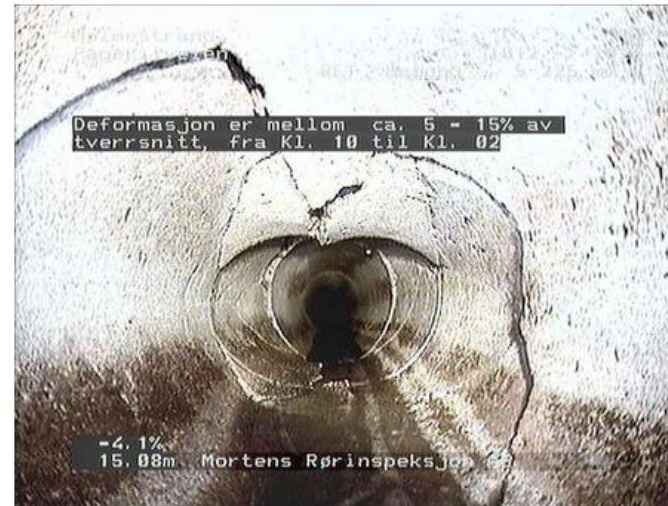
Foto: 8_5a, Tape nr.: 19159, 00:01:55 15,08m, Deformasjon er mellom ca. 5 - 15% av tverrsnitt, fra Kl. 10 til Kl. 02
