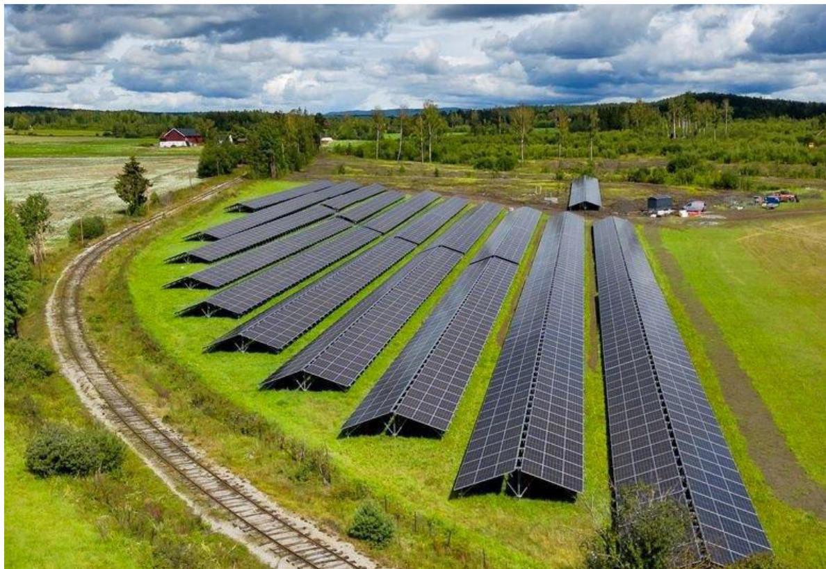
Figur 16 Eksempel fra Vikersund solpark - et bakkeanlegg montert mot øst-vest – et alternativ også relevant på gbnr.: 64/3. Kilde: Multiconsults mulighetsstudie
